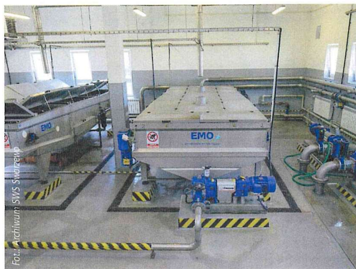
FOT. 4 Stacja mechanicznego zagęszczania osadów
